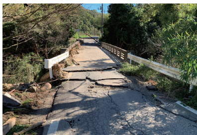
【道路陥没】谷川橋 ⑦【小川町角山】
