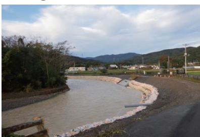
【護岸崩壊】一級河川 都幾川
