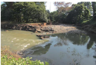
【護岸崩壊】一級河川 市野川 ⑥【小川町下小川】
