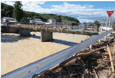
【道路・橋冠水】一級河川 槻川
