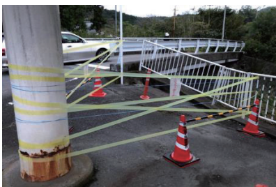
【兼用護岸洗掘、歩道陥没】 一般国道 254 号
