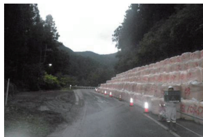
【積ブロック崩壊】県道大野東松山線
