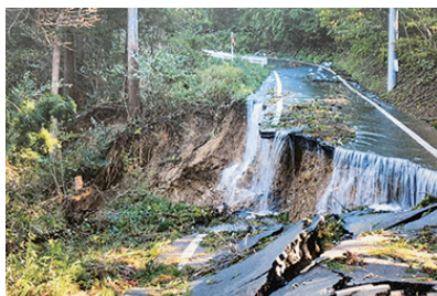
【道路陥没】県道大野東松山線
