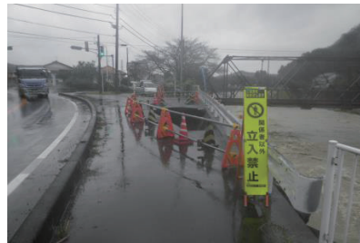
【兼用護岸洗掘、歩道陥没】 熊谷小川秩父線
