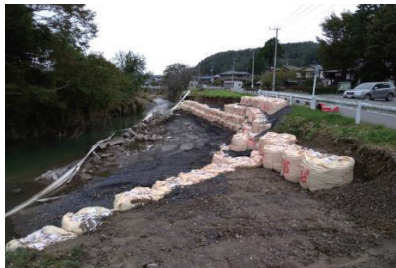
【護岸崩壊】一級河川 兜川
